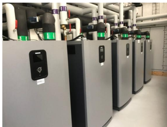
Figur 5: Eksempel på varmepumper fra Klimadan til biogasanlæg
