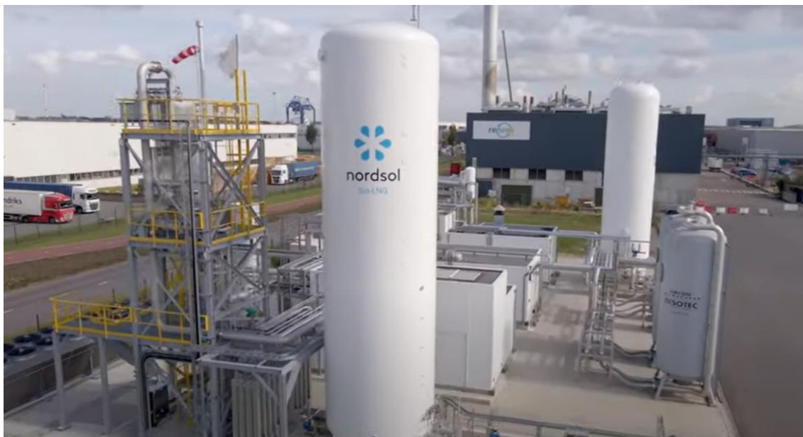
Figur 10: Billede af Nordsol anlægget i Amsterdam
